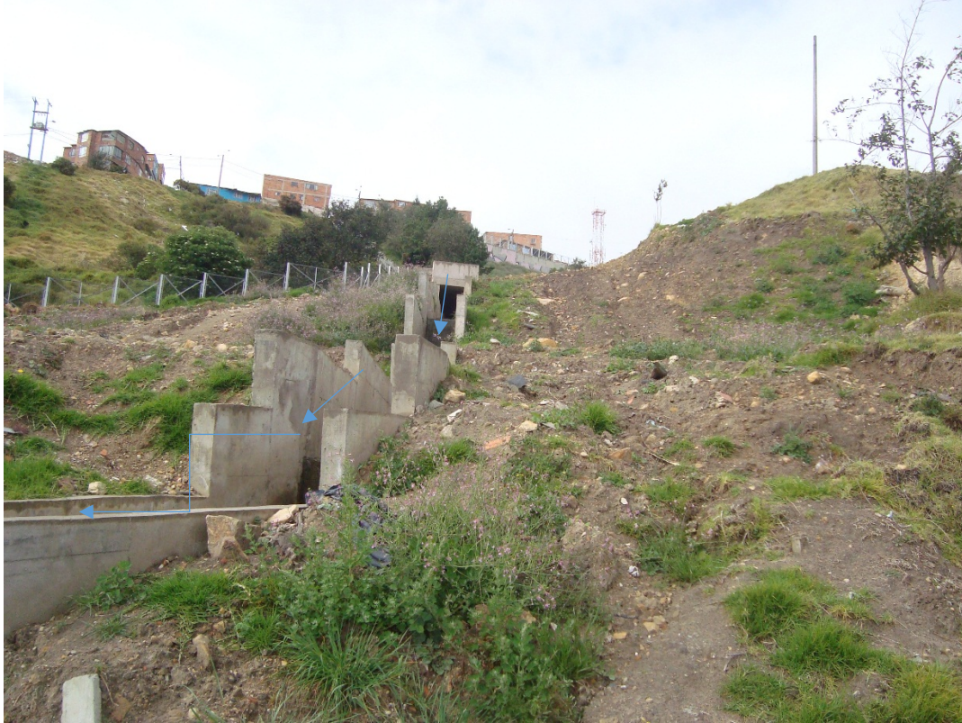
Fotografía N° 3. En construcción canal Trapeisoidal, zona con problemas de estabilidad, altos de la estancia.
