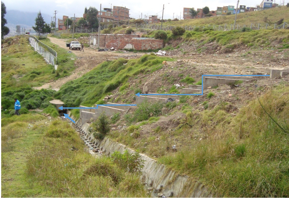
Fotografía N° 5. Sitio de cruce de la quebrada la carbonera con la estructura, el cual se el cual se georreferencio en las siguientes coordenadas así: X= 89455,105 y Y= 98029,659
