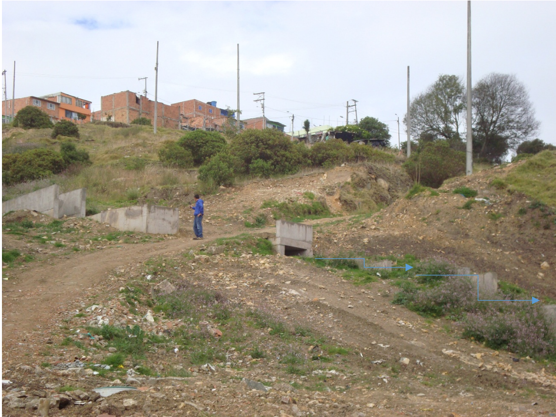
Fotografía N° 4. Se observa la construcción del Canal Trapezoidal el cual va perpendicular a la quebrada carbonera y se georreferencio en las siguientes coordenadas así: X= 89437,78667 y Y=97995,697.
